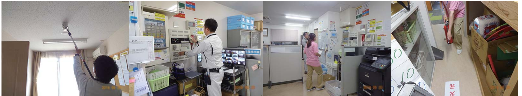
全館スプリングクラーの作動確認
